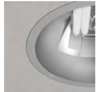
Diode für die Ladeanzeige der Notlichtbatterien.
